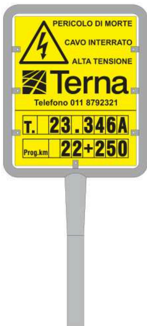
A CARTELLO DI SEGNALEZIONE LINEA IN CAVO
